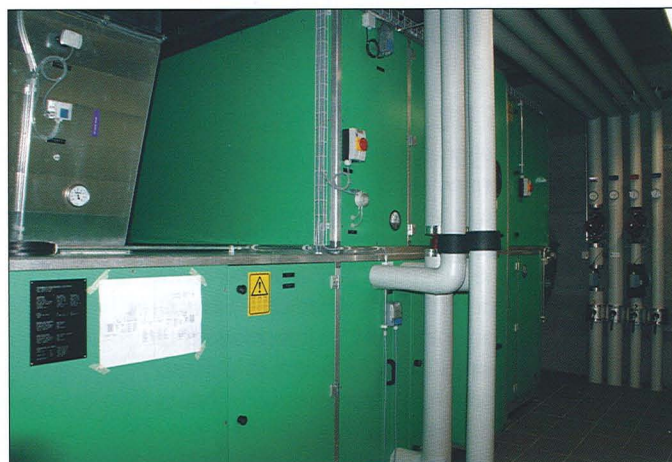
Gestion de la ventilation/climatisation, avec un potentiel de 18'850m3 d'air pulsé dans le bâtiment.
